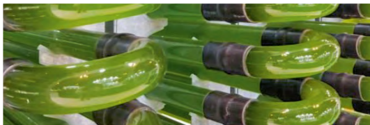
Detalle de las tuberías de la planta de producción de AlgaEnergy (fuente: Algaenergy)
